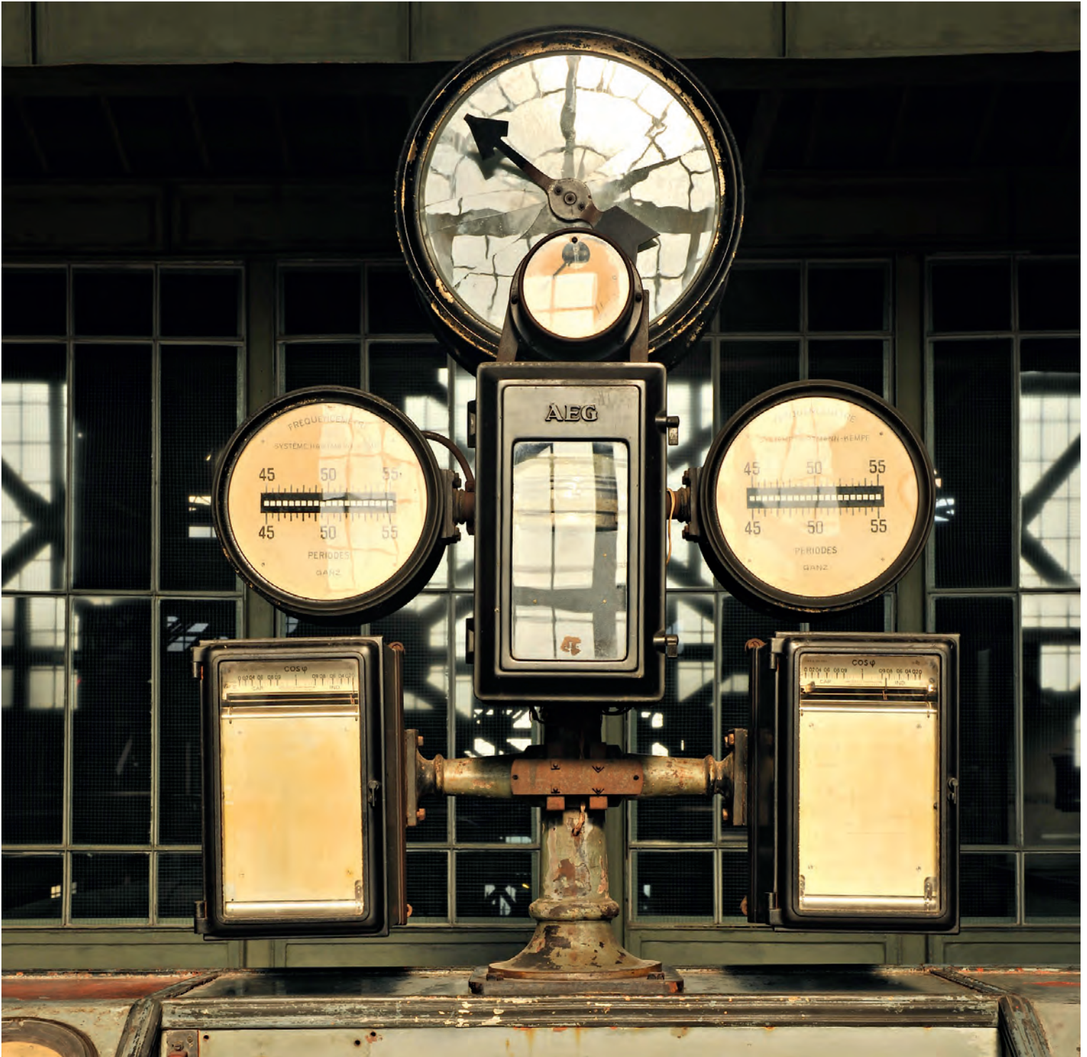
17- Silahtarağa Elektrik Fabrikası'ndaki senkronizasyon cihazlarından birisi
