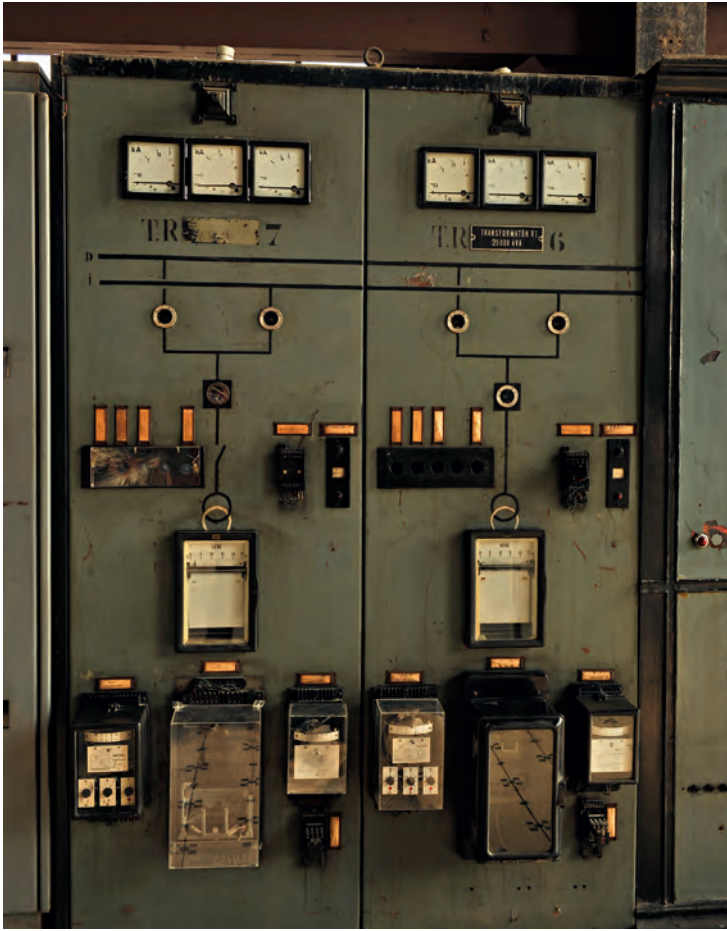
18- Silahtarağa Elektrik Fabrikası'ndaki 25.000 kVA'lık bir transformör
