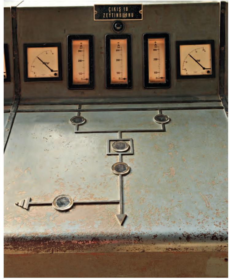
19- Silahtarağa Elektrik Fabrikası'nda elektriği bölgelere dağıtan transformörlerden 18 no'lu Zeytinburnu çıkışı
